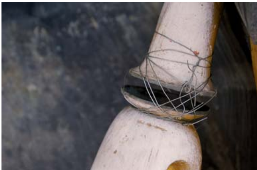
Neudržitelný stav Historické budovy dokumentuje i detail pořízený při průzkumu fasády jejího průčelí (2006).
