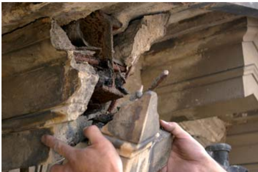
Rozpadající se konzole části korunní římsy hlavního průčelí Historické budovy Národního muzea (2006)
