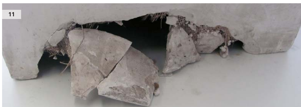
Obr. 11: Mechanické poškození soklu.
